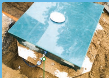
Электрический кабель в гофре
